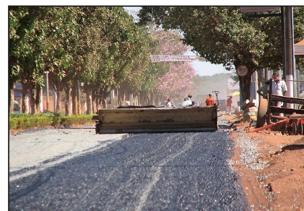
Asfalto na Avenida Dom Bosco.
