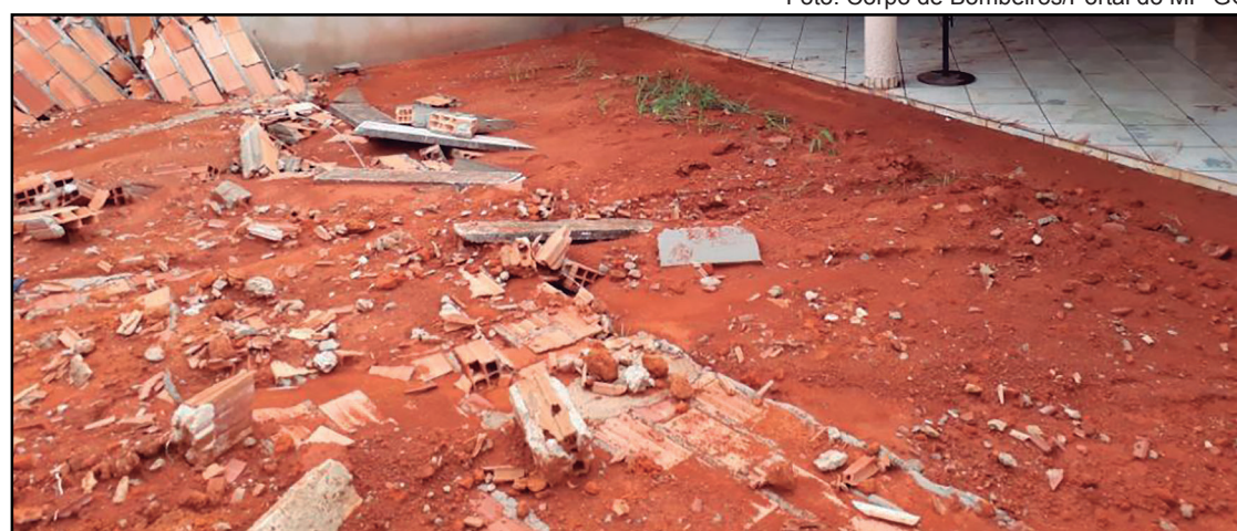
Muro que desabou com a enxurrada no bairro Jorge Barroso
