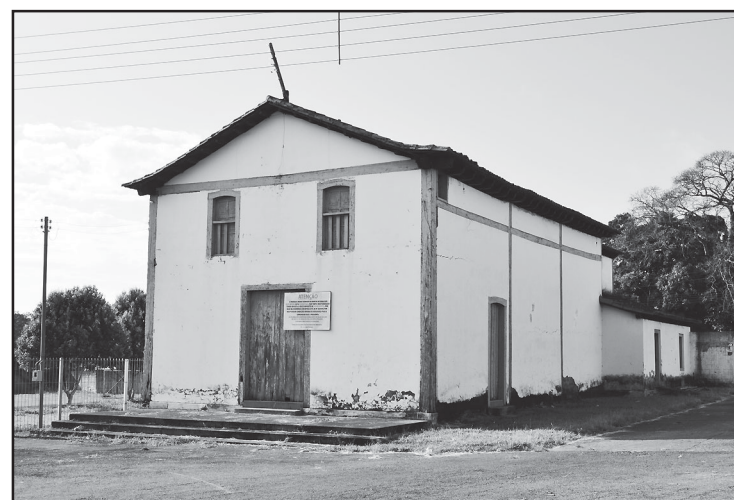
Igreja de São Sebastião, interditada pela Defesa Civil para evitar risco de desabamento, ficará fechada até o início das obras.
