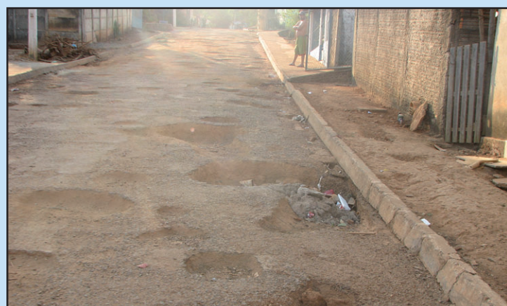
As ruas do Bairro Deco Correa estão bastante danificadas. Após conclusão da recuperação da Dom Bosco, obras terão início.
