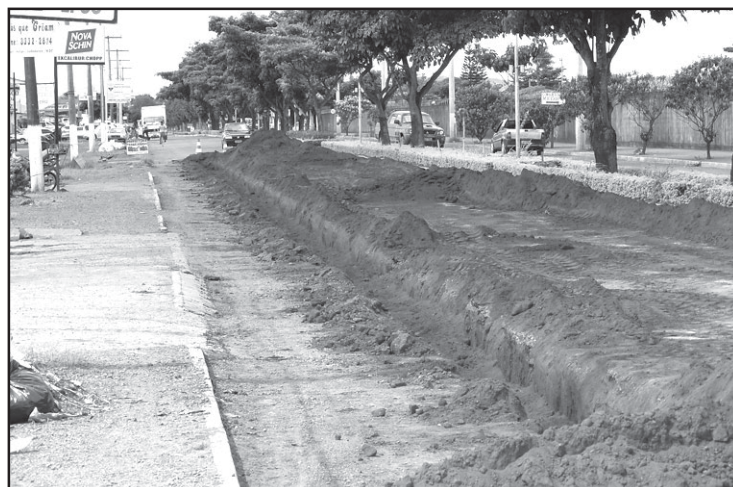
O canal aberto na avenida Dom Bosco provocou muita lama.
